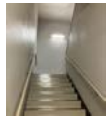
人感センサー 階段照明 (池下ESビル)
