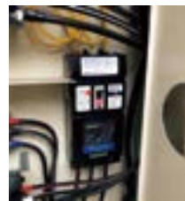
電子ブレーカー設置 (12物件導入済)
