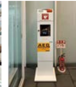
AED設置 (MRRデルタビル他)
