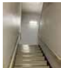
人感センサー 階段照明 (池下E Sビル)
