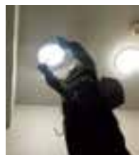
天井照明 (16物件導入済)
