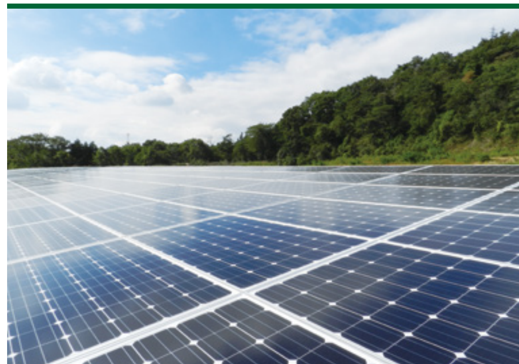
いちご桐生奥沢ECO発電所(群馬県桐生市)
