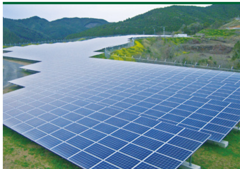
いちご都城安久町ECO発電所(宮崎県都城市)
