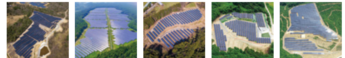
S-16 CS恵那市発電所 S-17 CS大山町発電所(A)、同発電所(B) S-18 CS高山市発電所 S-19 CS美里町発電所 S-20 CS丸森町発電所
