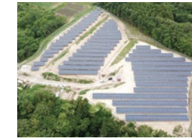
S-23 CS大崎市化女沼発電所
