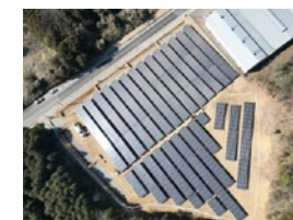
S-34 CSさくら市喜連川発電所
