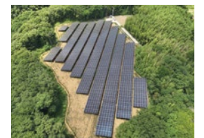
S-32 CS佐倉市発電所
