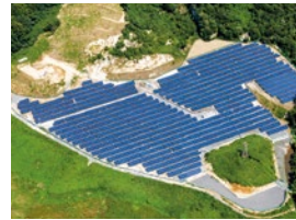
S-03 CS笠間市発電所
