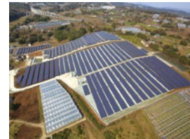
S-08 CS日出町発電所
