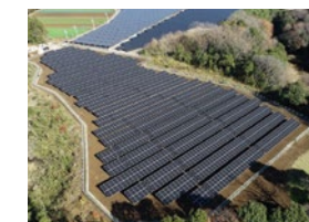
S-35 CSつくば市高見原発電所
