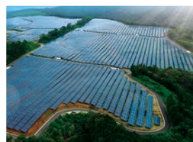
S-13 CS益城町発電所
