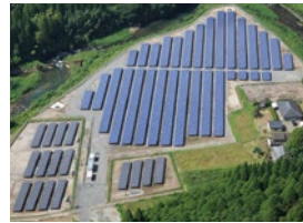
S-01 CS志布志市発電所
