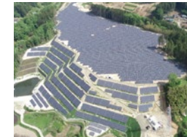
S-25 CS大河原町発電所
