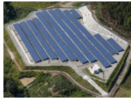
S-02 CS伊佐市発電所
