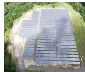
S-02 千代田高原太陽光発電所
