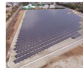
S-03 JEN防府太陽光発電所
