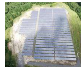
S-02 千代田高原太陽光発電所
