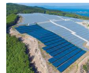
S-06 長崎琴海太陽光発電所
