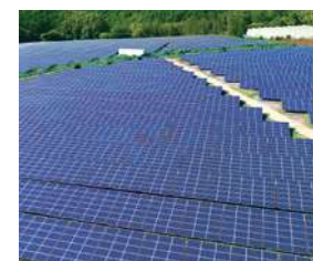
S-05 鉾田太陽光発電所
